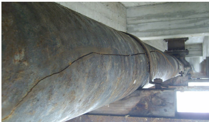
Casse conduite AEP DN250mm – Pont Roosevelt, Montélimar – Février 2012
